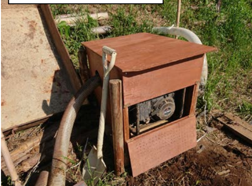
大活躍の揚水ポンプ
